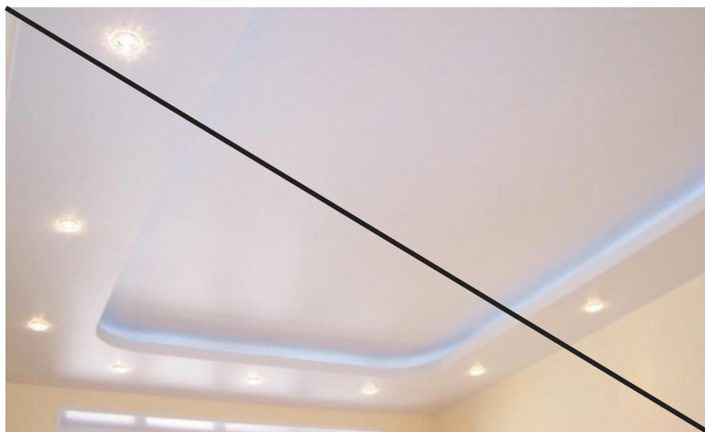
Плохо Многоуровневые гипсокартонные конструкции
