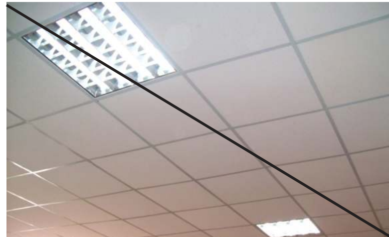
Плохо Открытые направляющие
